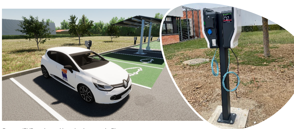
Bornes IRVE sur le parking des locaux de Blagnac
